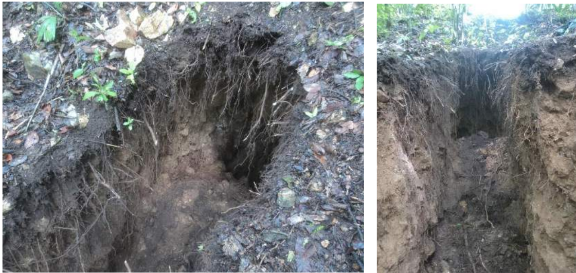
Figura 6.14 Vistas generales del área del colapso (Fotografías por R. López).
