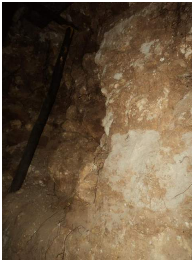
Figura 6.17 Vista del corte norte de la plataforma 13Q-2-Sub 4, detrás del muro de contención identificado (Fotografía por R. López).
